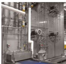
External fan motors
