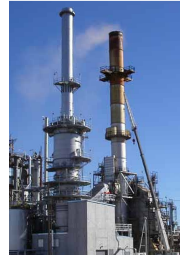
除尘脱硫塔，及苏打储罐、泵房、控制室
