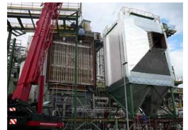
为满足更严格的排放要求, 加装了第四个电场
